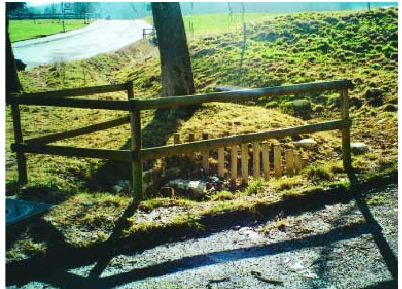
Der neu geöffnete Graben an der Stettbacherstrasse leitet Sicker- und Regenwasser in den Hirzenbach.
